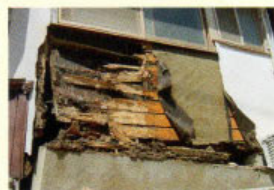
シロアリ被害にあっていたため崩れた外壁。
