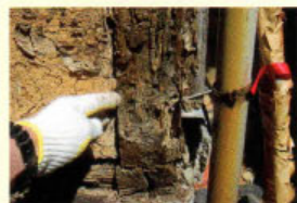
シロアリに食べられてボロボロになった柱・土台。
